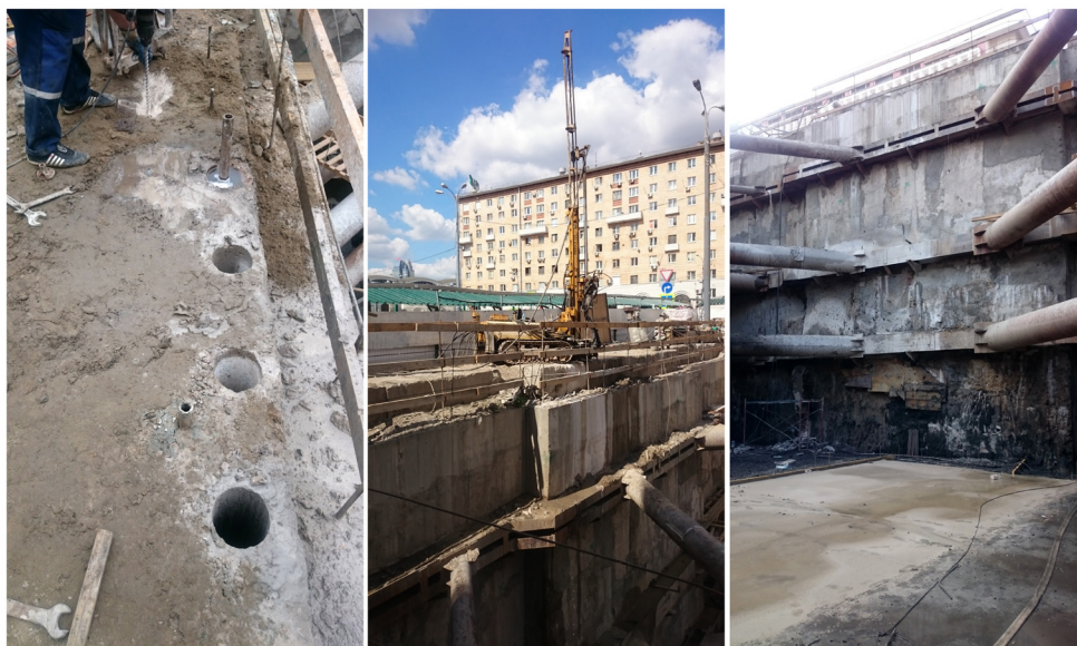
Рис. 4. Процесс производства работ по однокомпонентной струйной цементации: а – алмазное сверление; б – устройство противофильтрационной конструкции; в – разработанный до проектной отметки котлован
